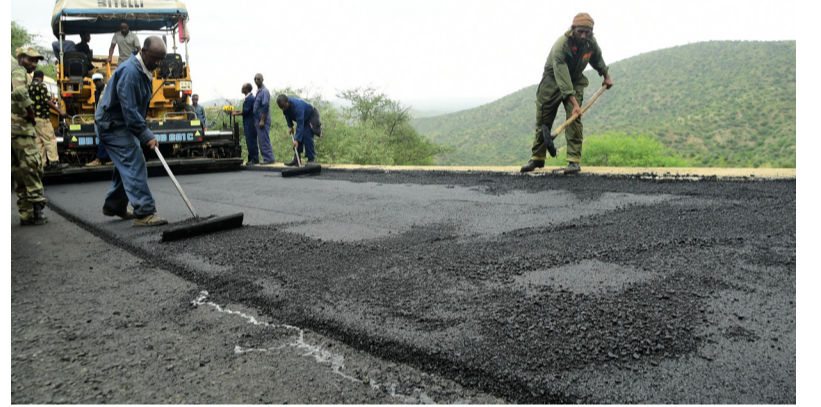
تجري اعمال اصلاح وتحديث لطريق اسمر-مصوع المسفلت. ووضح احد المشرفين على العمل المهندس/سيوم تخلي، ان البرنامج الذي
